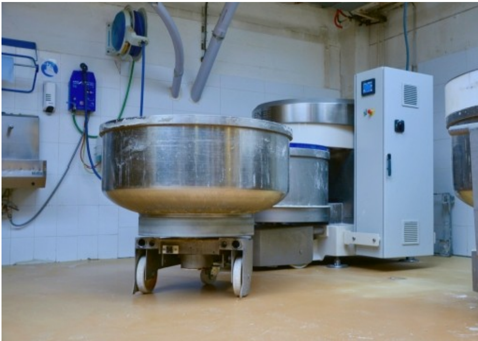
De vloer moest tegen zware mechanische belastingen bestand zijn. Er passeren ketels van 1.000 kilogram over, die rusten op drie nylon wielen
